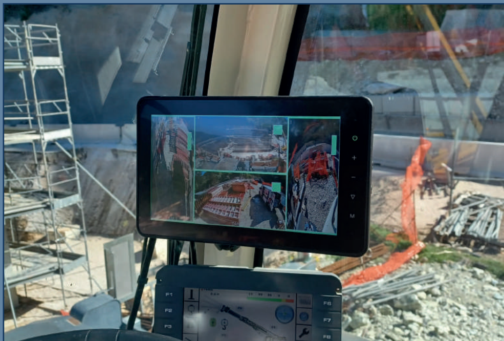
Il monitor in cabina mostra contemporaneamente le immagini delle telecamere, aiutando l'operatore a controllare l'area circostante.
