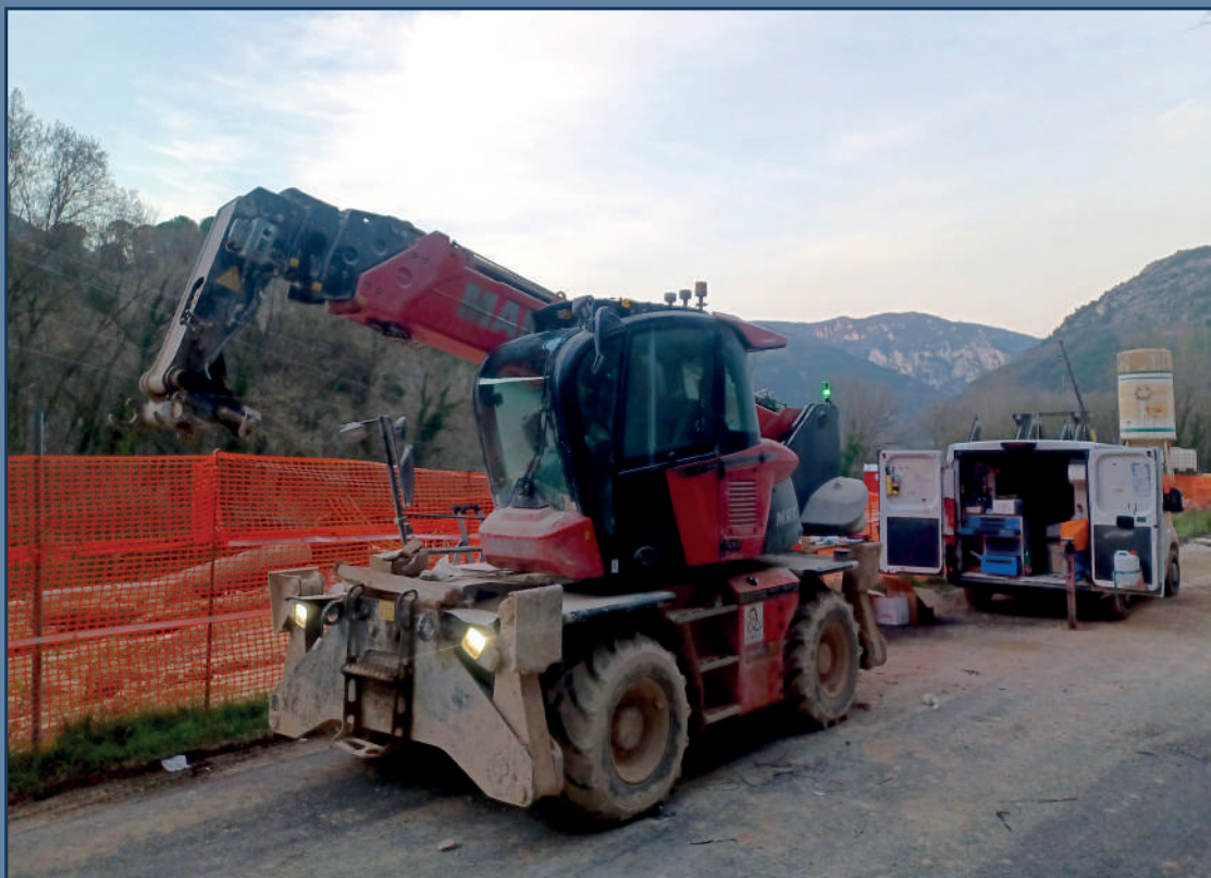
La configurazione dei sistemi di rilevamento deve tenere conto delle caratteristiche del mezzo e delle condizioni operative del cantiere.
